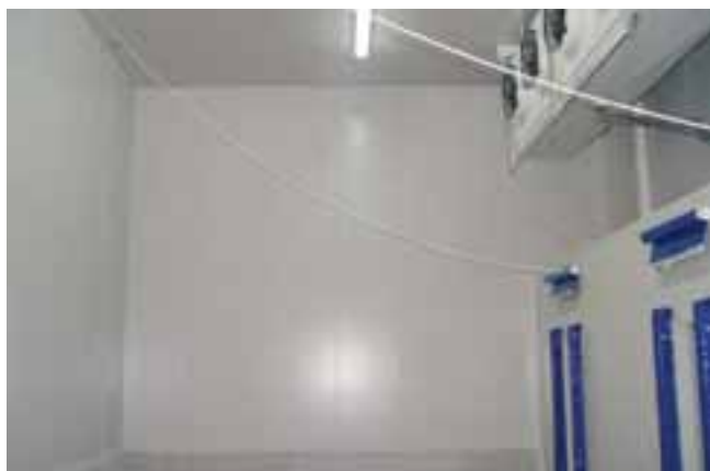
Celle frigorifere realizzate con pannelli Isofrigo.
